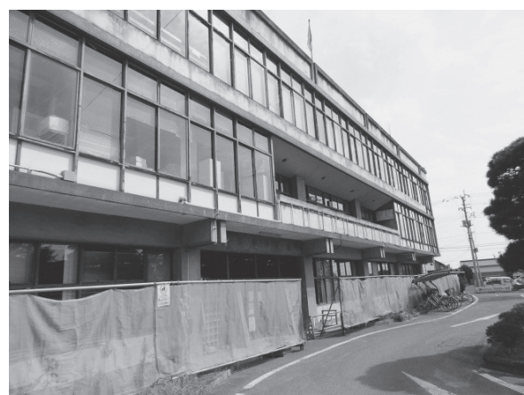
強い揺れによって役場本庁舎は、被害を受け危険建物となった
