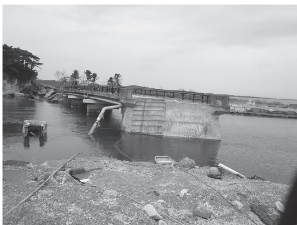
宮戸地区へ通じる唯一の橋が崩落
