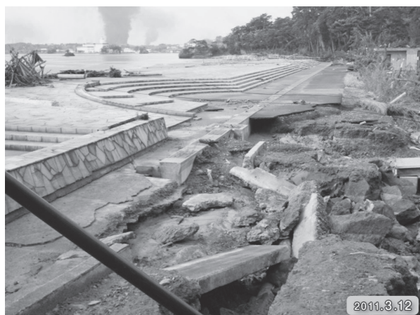
煙を上げているは仙台港のコンビナート火災(写真奥)
