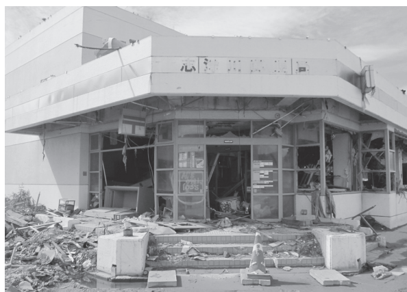
津波の凄まじさを見せつけている被災建物
