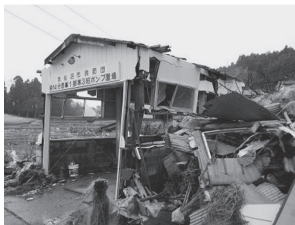
本吉町大沢漁港の被害状況
