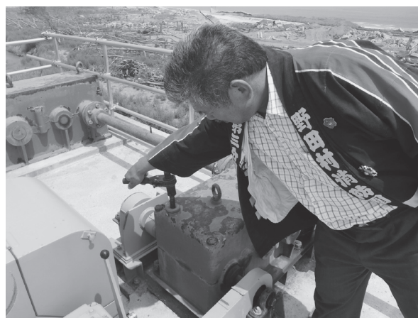
手動式の水門開閉装置。ハンドルを回すことで水門を上げ下げする。
