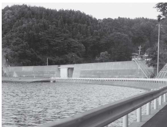
消防団員が開めた水門
