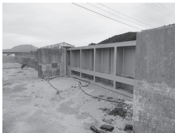
閉鎖操作した水門
