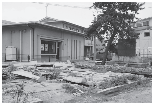
床上浸水した消防団詰所
