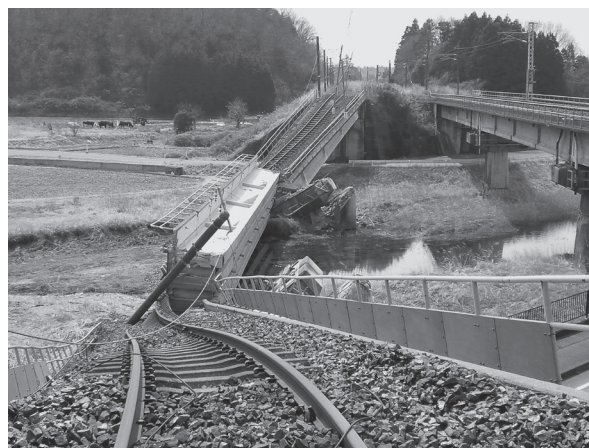
前田地区跨線橋上地震被害
