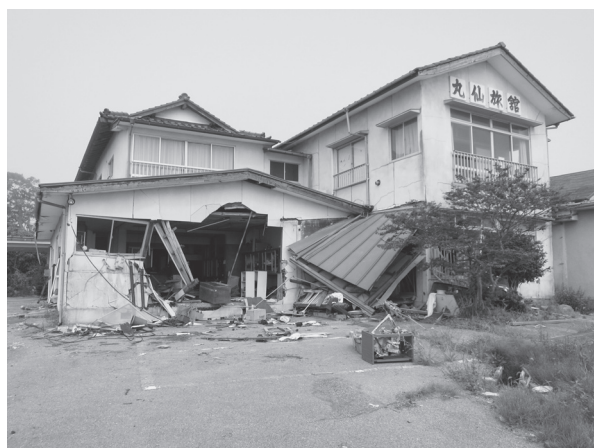
建物1階部分が破壊され、住めない状態
