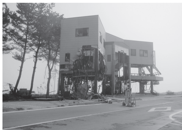
1階から2階部分が津波で破壊された建物
