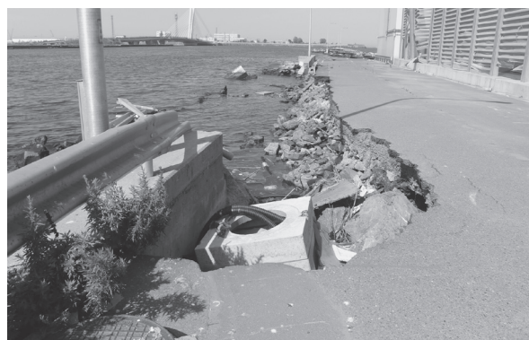
陥没した港の防波堤に続く道路
