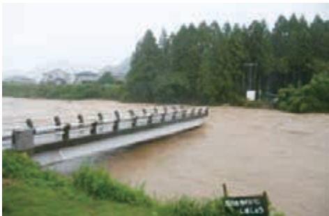
流出した飛川橋（小浜市中井）
