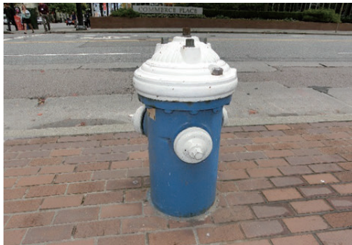
(ダウンタウンに設置されている高圧消火栓)
