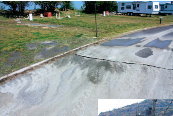
被災地状況 (淡路市塩田新島)
