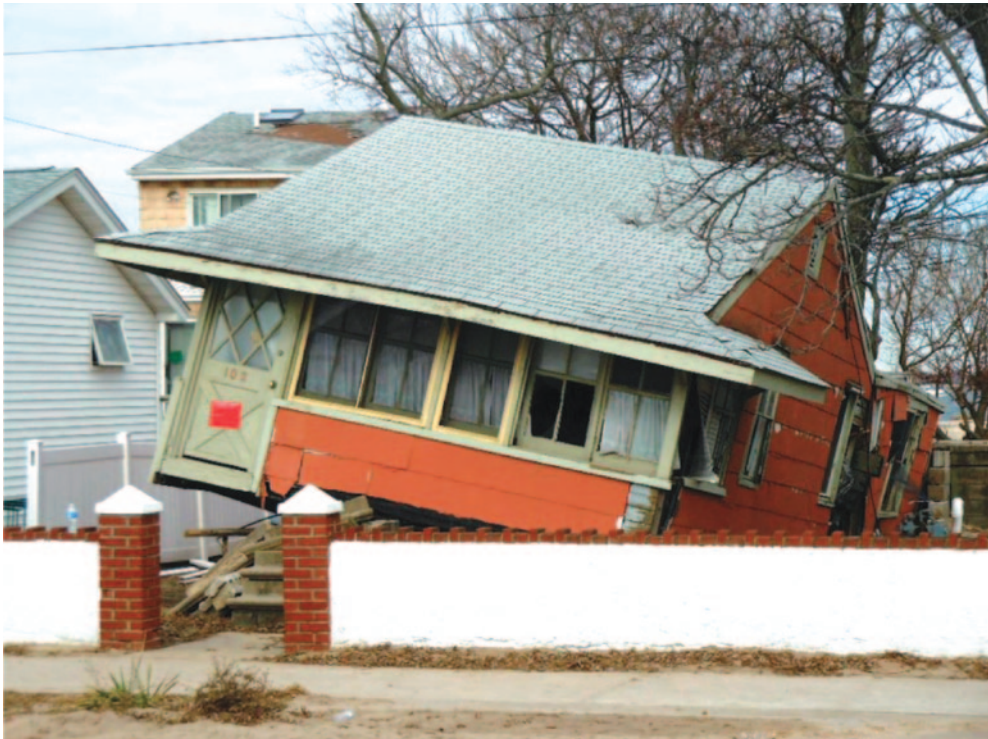
基礎を失い傾く住居
