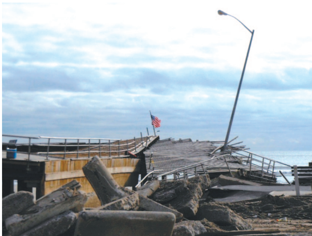
完全に破壊された海岸の遊歩道
