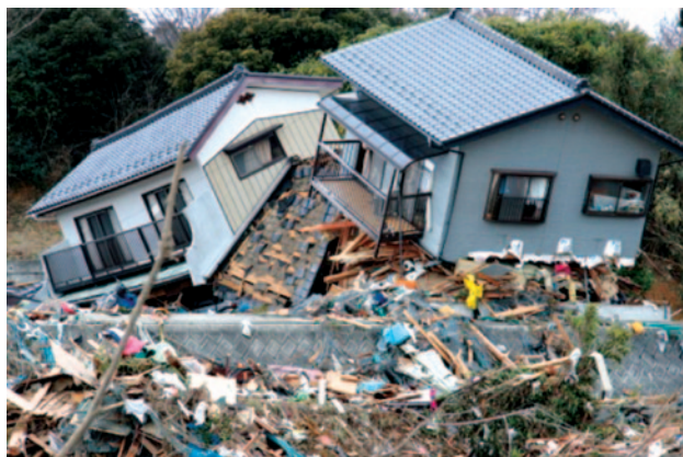
3.11東日本大震災被災状況
