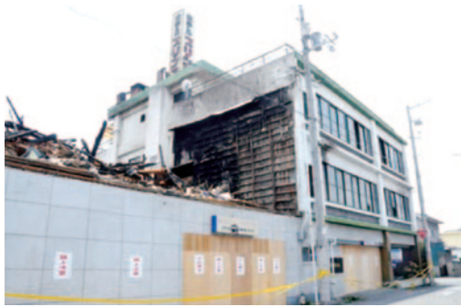
火災建物の外観
