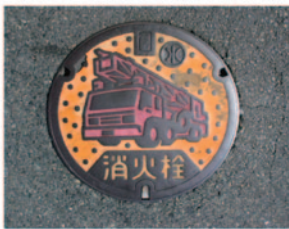
地下に埋設された消火栓の例
