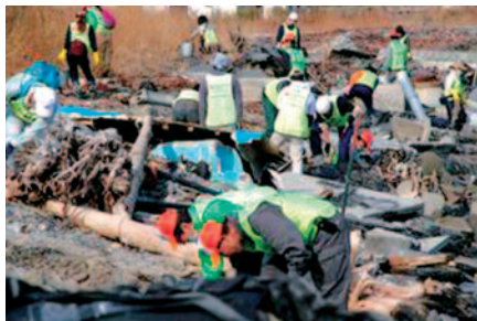
平成24年7月九州北部豪雨 耶馬溪町下郷地区での家屋の泥かき作業 (写真提供：大分県中津市役所)
