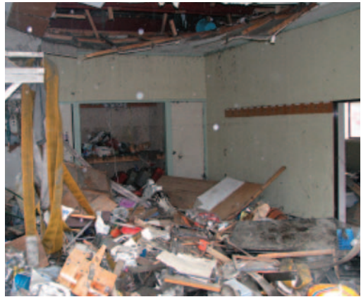
被災した消防屯所の内部
